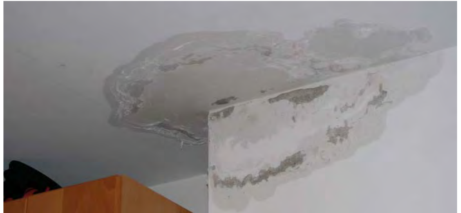
Abbildung 14: Massive Feuchtigkeitsspuren an der Deckenunterseite.
